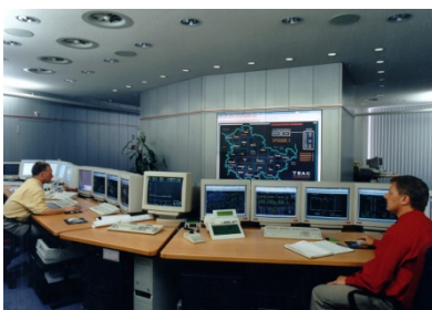
Netzleitzentrale E.ON Thüringer Energie AG
